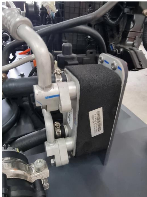
รูปที่ 4.36 ท่อสารทำความเย็นระบบปรับอากาศต่อเข้าอุปกรณ์แลกเปลี่ยนความร้อน ทำหน้าที่ลดอุณหภูมิน้ำหรือสารทำความเย็นก่อนไหลเวียนไปที่แบตเตอรี่
